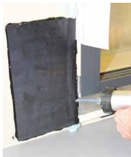
Dichtungsfolie mit Befestigungsblech für seitliche Schwellenanbindung mit dauerelastischen Dichtstoff Teroson zum Element versiegeln.
